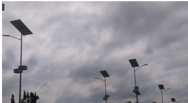
Fig. VI.9. Instalaciones para aprovechar energía solar en Colombia.
